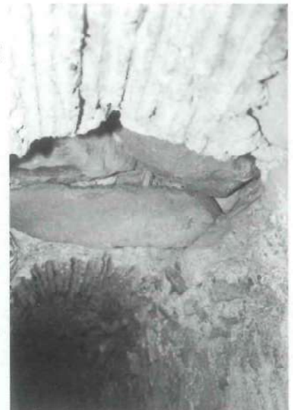
Fig. 6 - Detalle de uno de los agujeros abiertos en la bóveda de la galería para extraer el agua. Se aprecia cómo fue cegado con grandes piedras al quedar inutilizado.
