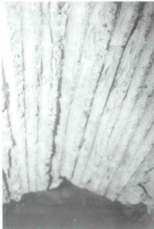
Fig. 7 - Detalle de la bóveda de la galería, construida con mortero de cal utilizando cañizo como encofrado.
